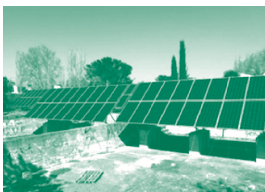
Parque solar de Las Balsas
